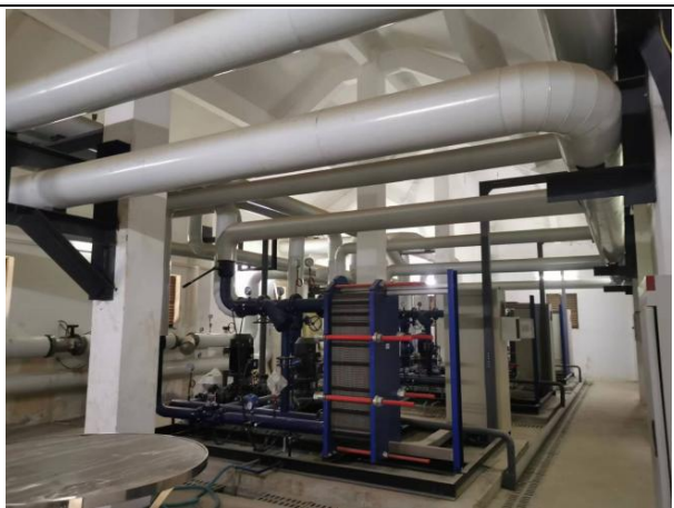
热交换站设备间
