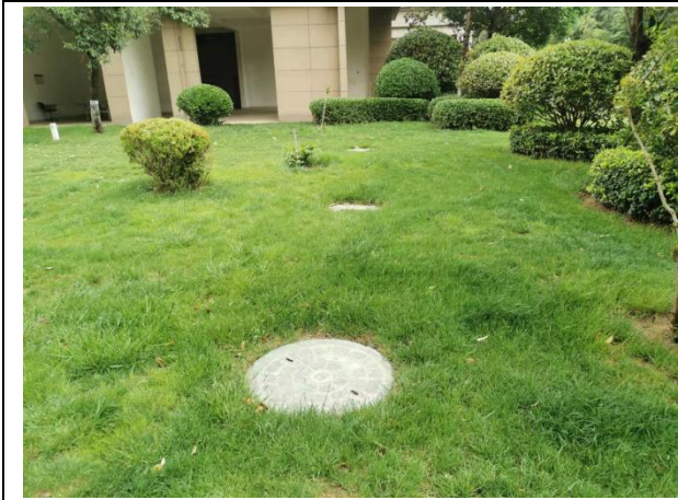
西北门 20-21 号楼之间化粪池
