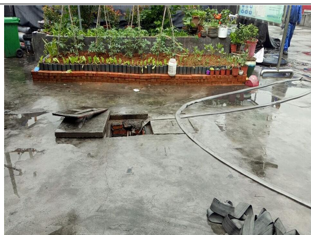
初期雨水收集池
